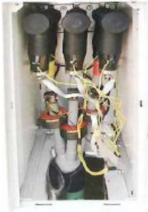
电缆室电缆连接
